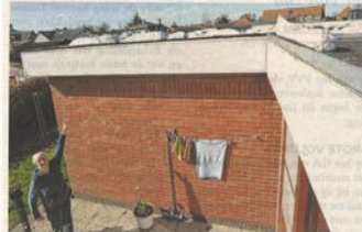
Rafaëlla Ketels toont haar beschadigde dak. (Foto MVN)
